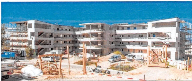
Das Mehrgenerationenhaus „Wannenacker“ an der Petit-Landau-Straße steht kurz vor der Fertigstellung. Noch diesen Monat können voraussichtlich die ersten Mieter einziehen.
